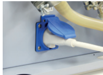
Steckdose zum Anschluss und Steuerung der Vakuumpumpe
